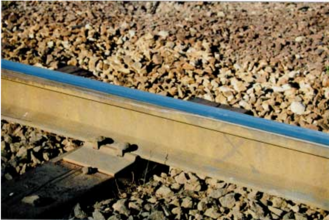
Kuva 2. Kemikaalivaunun suistuminen raiteilta Helsingin Länsisatamassa 5.9.1998. Suistumisen alkamiskohta. Rata kaartunut oikealle noin viiden metrin matkalla kunnes oikeanpuoleisessa kiskossa näkyy tuore naarmu telin oikeanpuoleisen pyörän pudottua kiskon vasemmalle puolelle.
