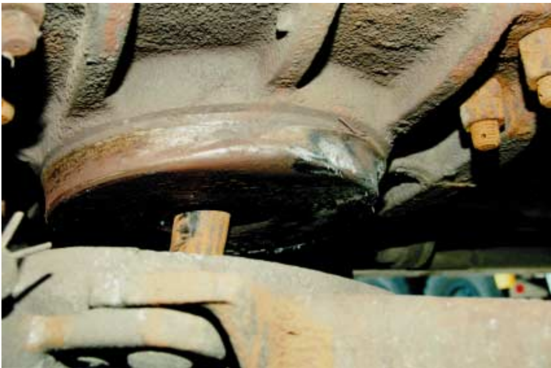
Kuva 7. Kemikaalivaunun suistuminen raitelta Helsingin Länsisatamassa 5.9.1998. Venäläisen vaunun rosoinen ja voitelematon telikeskiö.
