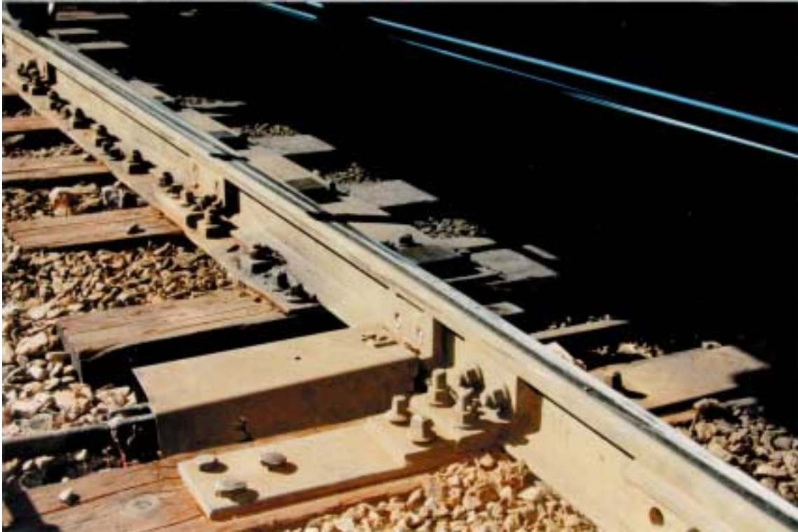
Kuva 4. Kemikaalivaunun suistuminen raiteilta Helsingin Länsisatamassa 5.9.1998. Tulo vaihteeseen 372. Telin vasemmanpuoleiset pyörät nousseet kiskon yli. Vaihteesta on katkennut pultteja.
