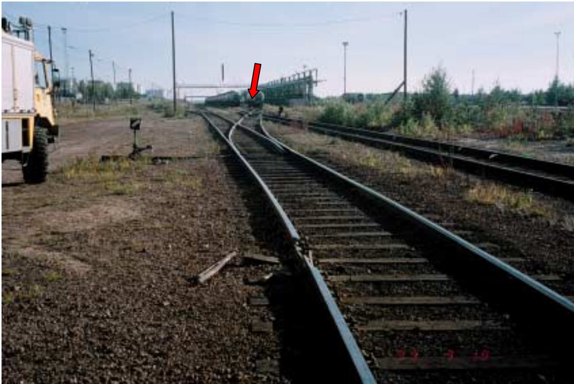
Kuva 6. Säiliövaunun suistuminen kiskoilta Haminan satamassa 19.9.1999. Vaihtotyök-sikkö veti nuolen osoittamalta raiteelta vaunuja kohti edessä näkyvää raidetta 417.
