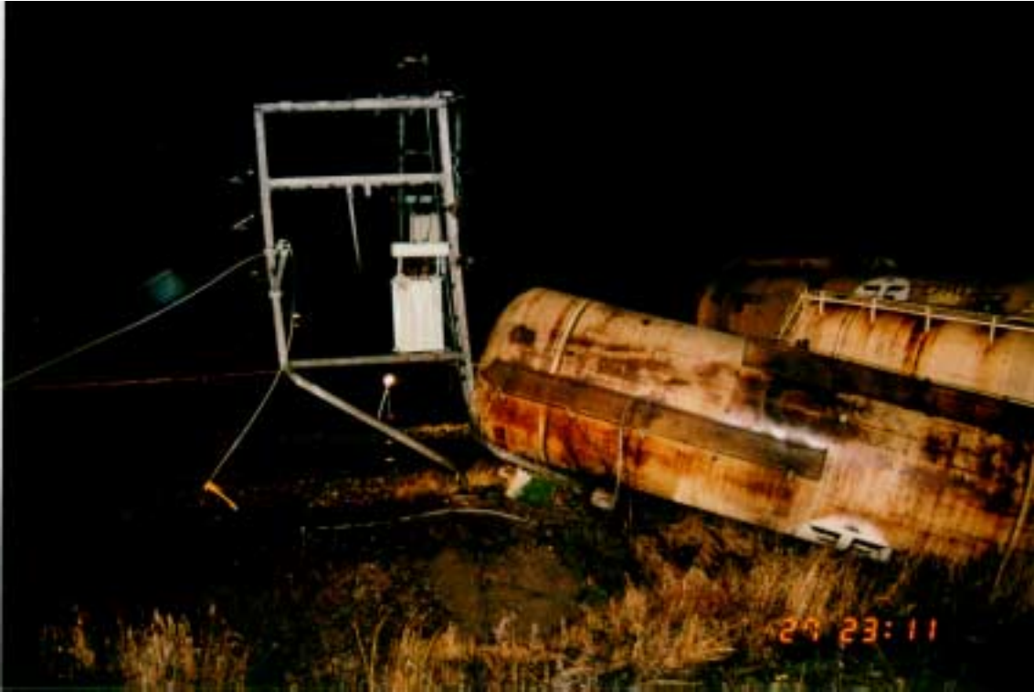
Kuva 7. Vaurioitunut portaalin jalkapylväs, jossa on imumuuntaja.
