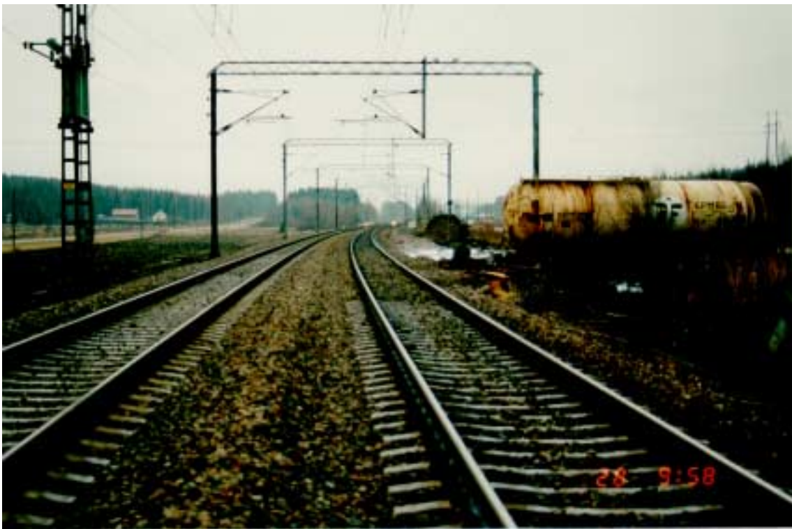
Kuva 8. Rikkoutunut turvaraide ja raidepuskin.
