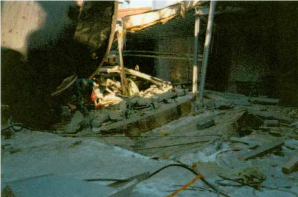
Kuva 4.1.3E Peruslaatan leikkautunut ja kallistunut keskiosa.
