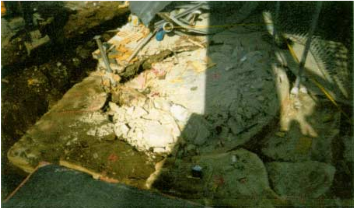
Kuva 4.1.3C Yleiskuva murtuneesta peruslaatasta. Kuvasta käy ilmi murtokuvio ja kappaleet, joihin laatta oli lohkeillut (vrt. kuva 4.1.3B)
